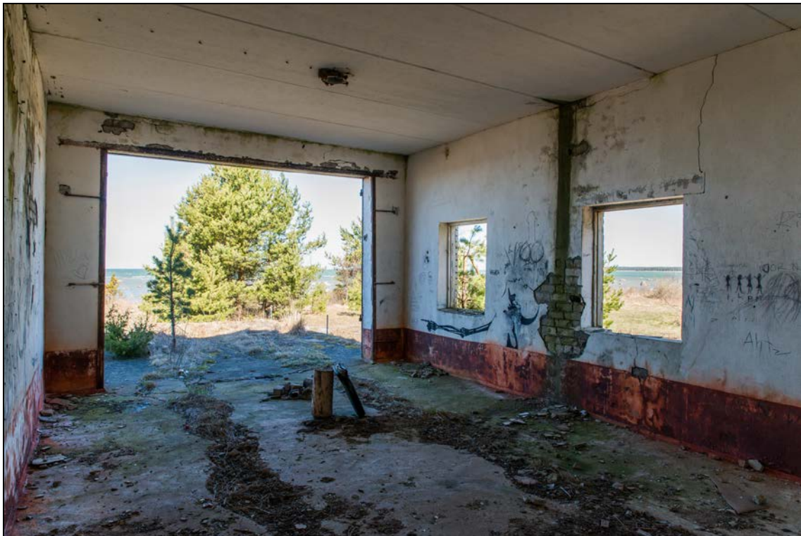
Foto 5 (209). Ramsi tehnilise vaatluse post [1], prožektori ruum. Põrand laguneb, aga lagi on veel täiesti korras.
